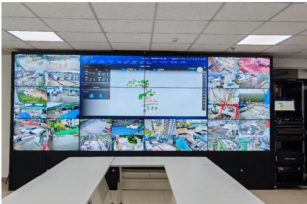
图片 7：学校数据中心监控
