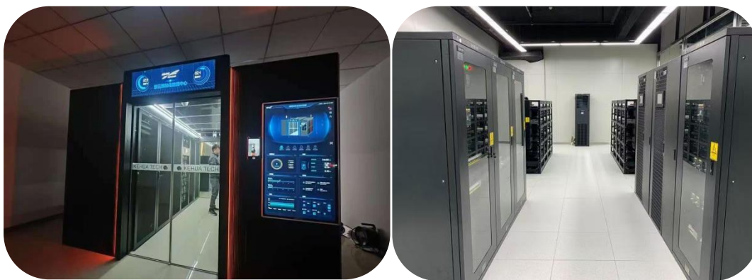
图片 6：数据中心机房
